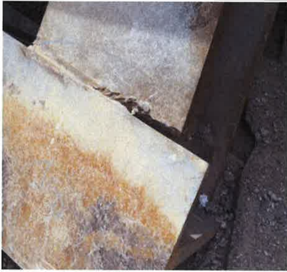
Soldadura no concluida en la junta de la sección trabe T-6 y trabe Puente
