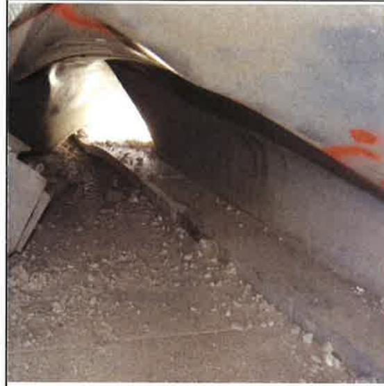
Trabe T-7 mostrando deformación y desprendimiento de la luminaria de soporte
